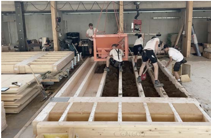
Vorfertigung der Deckenelemente bereits in der neuen Halle. Für einen guten Schallschutz wurden die Gefache mit Lehm aus dem Baugrubenaushub verfüllt.
